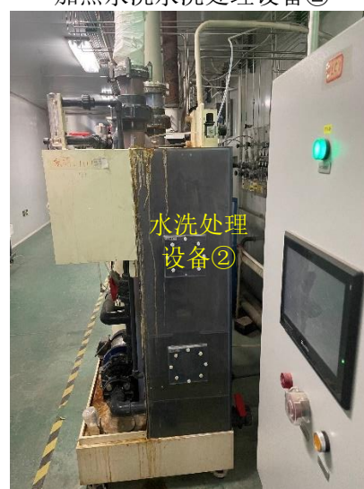
水洗处理设备②
