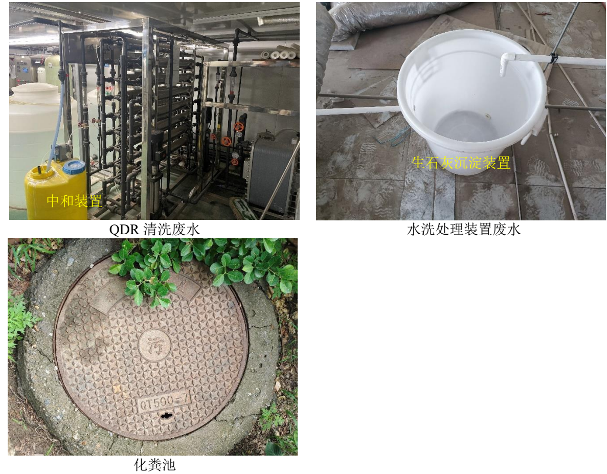
图 14 厂区废水水处理设施图
